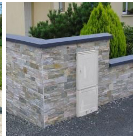
Intégration des coffrets techniques dans un muret maçonné
