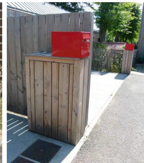
Intégration des coffrets techniques dans un habillage bois
